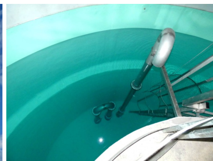
La cuve remplie avec les départ et arrivée d'eau potable
